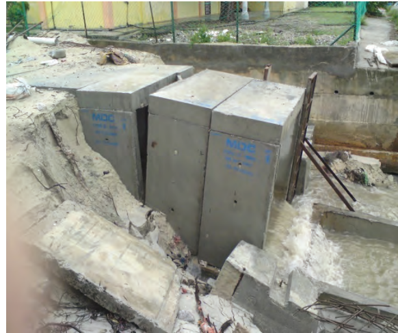
Foto 3.27 Struktur Culvert Telah Pecah
