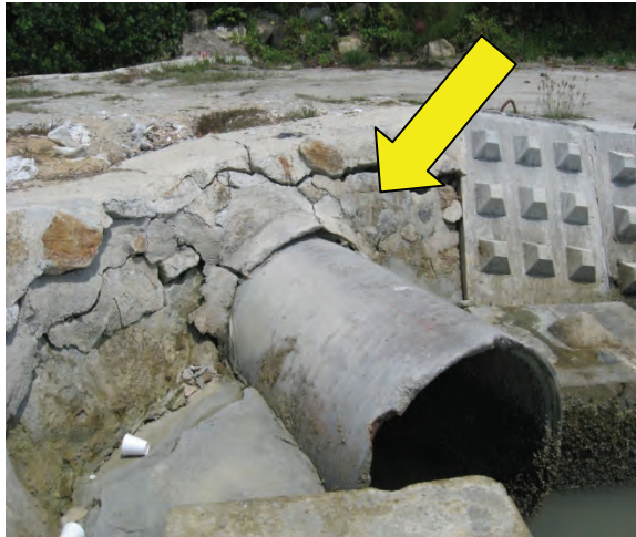
Foto 3.21 Keretakan Antara Culvert Dan JPS Blok
