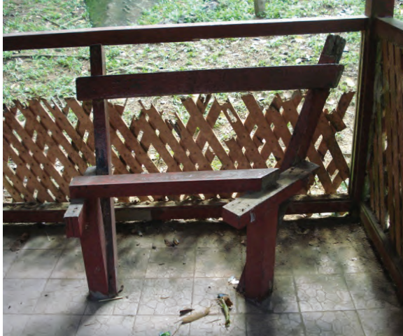
Foto 2.18 Bangku Rosak Di Pondok Rehat HLBM Dan Tidak Dibaiki
