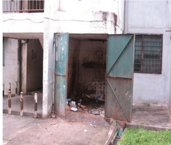
Foto 7.18 Tong Sampah Tidak Disediakan Di Pelongsor Sampah
