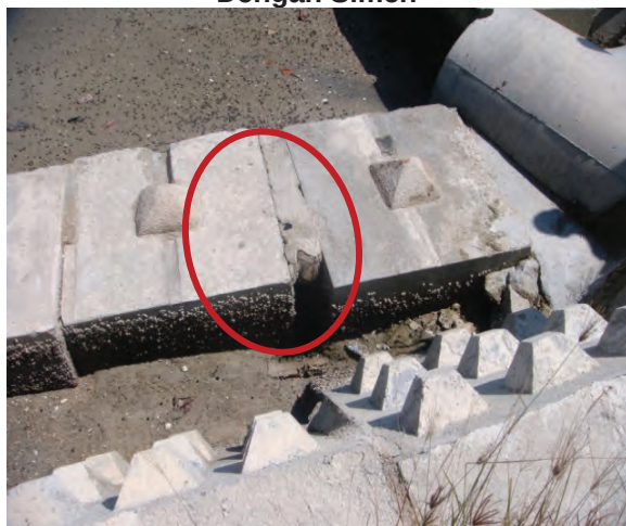
Foto 3.5 Kerenggan JPS Blok Telah Ditutup Dengan Simen
