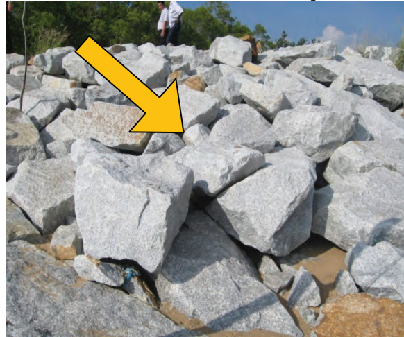
Foto 3.14 Susunan Batu Granit Yang Tidak Rata Dan Tidak Kemas Permukaannya
