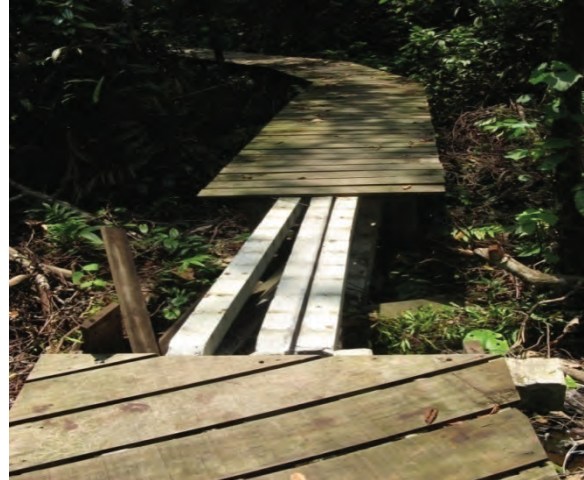
Foto 2.19 Pelantar Wetland Di TNBP Rosak Dan Tidak Dibaiki
