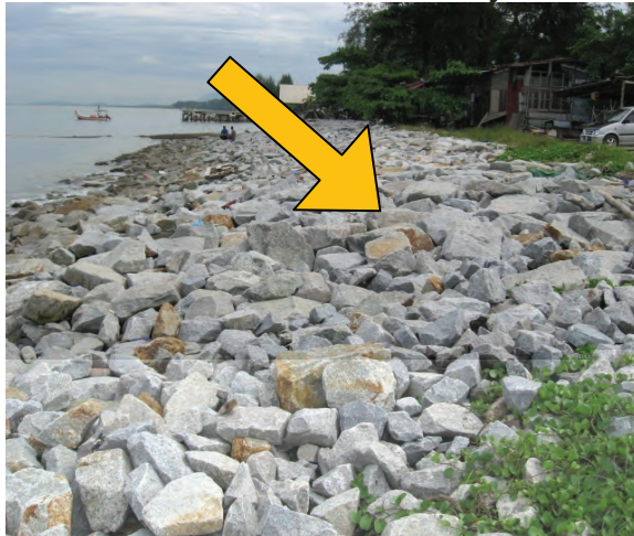
Foto 3.13 Susunan Batu Granit Yang Tidak Rata Dan Tidak Kemas Permukaannya
