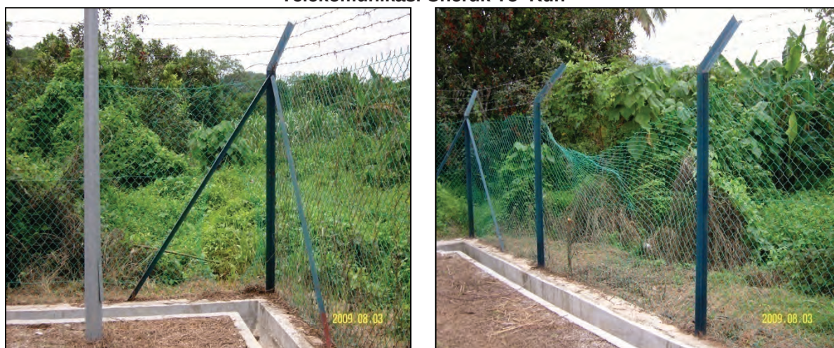
Foto 11.1 Keadaan Pagar Rosak Dan Kesan Pencerobohan Di Tapak Menara Telekomunikasi Cheruk To' Kun
