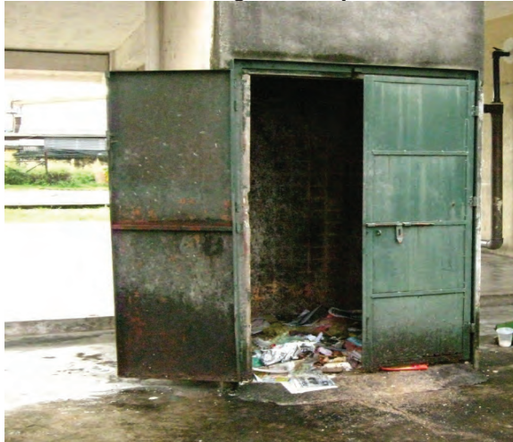
Foto 7.17 Tong Sampah Tidak Disediakan Di Pelongsor Sampah
