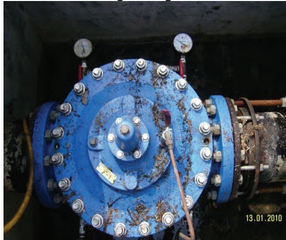
Foto 8.8 PRV Yang Dipasang Untuk Mengawal Tekanan Air Berfungsi Dengan Baik
