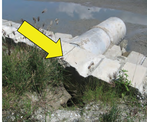
Foto 3.4 Kesan Hakisan Berlaku Di Belakang Binaan JPS Blok
