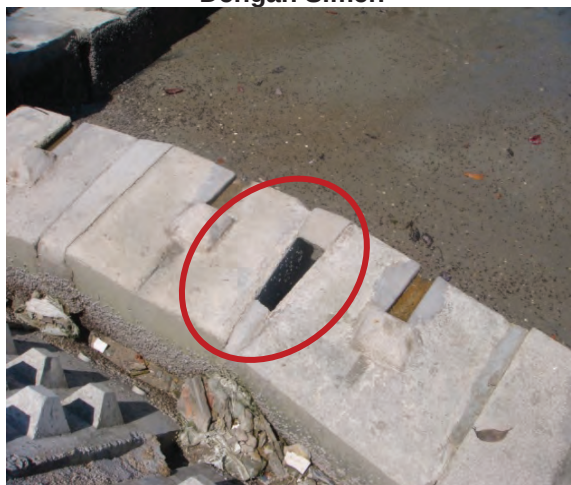
Foto 3.6 Kerenggan JPS Blok Telah Ditutup Dengan Simen
