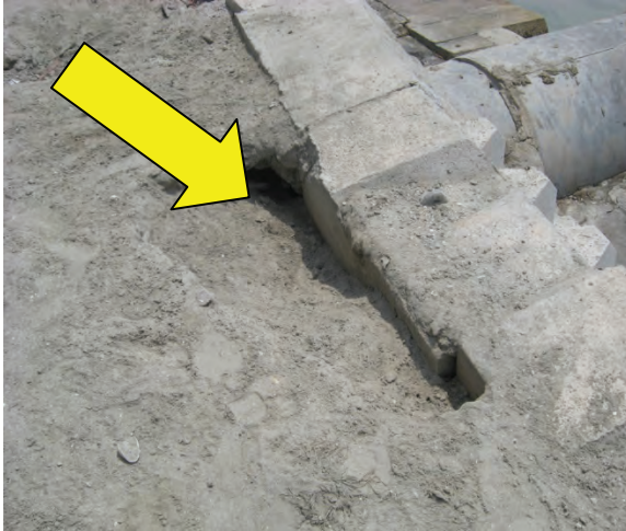
Foto 3.3 Kesan Hakisan Berlaku Di Belakang Binaan JPS Blok
