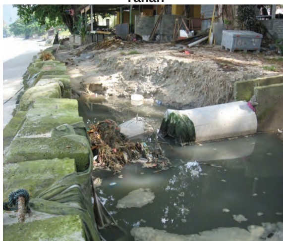
Foto 3.24 Binaan Culvert Ke Laut Yang Tidak Sempurna Dan Berlaku Pencemaran Serta Hakisan Tanah
