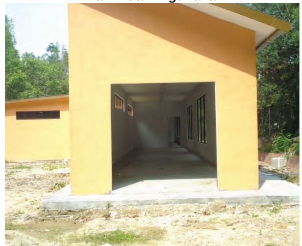
Foto 2.4 Bangunan Pameran Serangga Yang Terbiar Dan Tidak Digunakan
