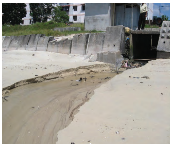
Foto 3.23 Binaan Culvert Ke Laut Yang Tidak Sempurna
