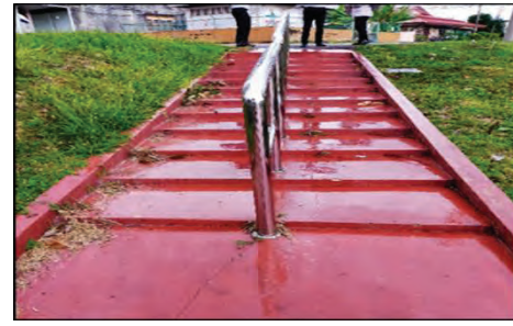
Laluan Pejalan Kaki di Bandar Merlimau - Laluan Pejalan Kaki Tidak Dilengkapi Dengan Concrete Imprint (25.10.2022) (Sumber: Jabatan Audit Negara)
