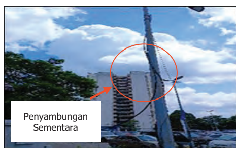
PPR Lembah Subang 1 - Keadaan Feeder Pillar yang dibuat Penyambungan Sementara dengan Tiang Lampu Sedia Ada Berdekatan (24.11.2022) (Sumber: Jabatan Audit Negara)
