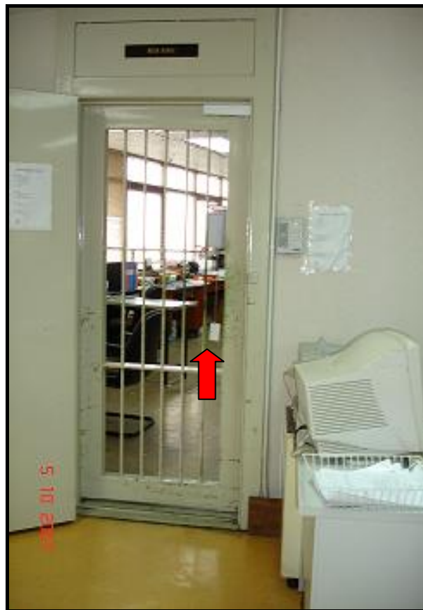
Foto 44 Pas Masuk Diikat Pada Pintu Bilik Kebal
