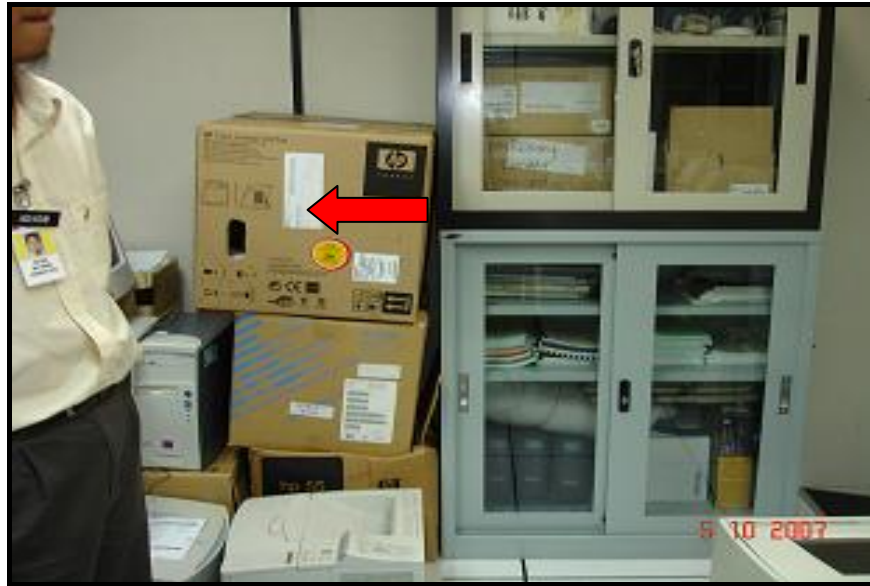
Foto 39 Bahan Mudah Terbakar Disimpan Di Bilik Server
