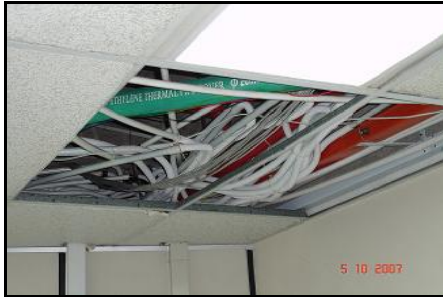
Foto 42 Siling Yang Terbuka Di Bilik Server
