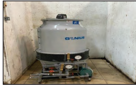
ABM Wilayah Tengah Cooling Tower Tidak Digunakan Sejak Penerimaan Tahun 2018 (30.05.2023) (Sumber: Jabatan Audit Negara)
