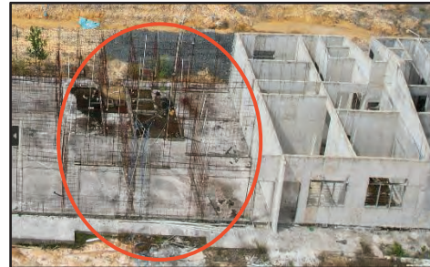
Projek PPK Al-Muktafi Billah Shah, Terengganu - Pengaratan Pada Besi Yang Telah Dipasang (20.02.2023) (Sumber: Jabatan Audit Negara)
