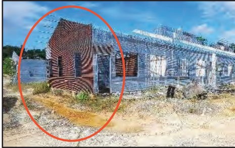
Projek PPK Al-Muktafi Billah Shah, Terengganu - Pengaratan Pada Bahan Binaan Sistem IBS (20.02.2023) (Sumber: Jabatan Audit Negara)
