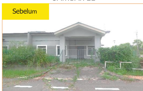
PPR Petra Jaya I, Bahagian Kuching - Kawasan Perumahan Ditumbuhi Semak Samun (12.08.2022) (Sumber: Jabatan Audit Negara)
