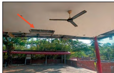
Restoran 1 Malaysia - Siling yang Berlubang dan Rosak (27.02.2023) (Sumber: Jabatan Audit Negara)
