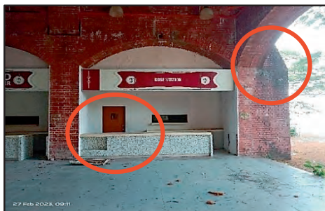
Restoran 1Malaysia - Kemasan Kedai yang Rosak dan Dinding Berlumut (27.02.2023) (Sumber: Jabatan Audit Negara)
