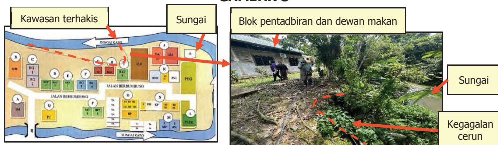
SK Ulu. Kabo, Sarawak - Mendapan dan Kegagalan Cerun Berlaku di Seluruh Kawasan Sekolah Disebabkan Lokasi Sekolah yang Dikelilingi oleh Sungai Kabo Boleh Menjejaskan Keselamatan Sekolah (16.02.2023) (Sumber: Jabatan Audit Negara)
