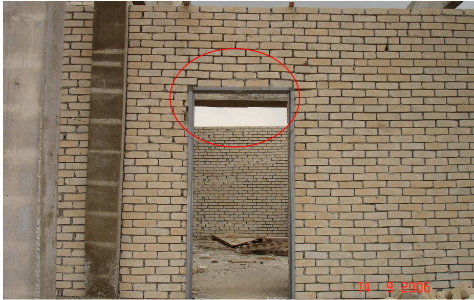
Foto 24 Tiada Lintol Dipasang Di Atas Kerangka Pintu
