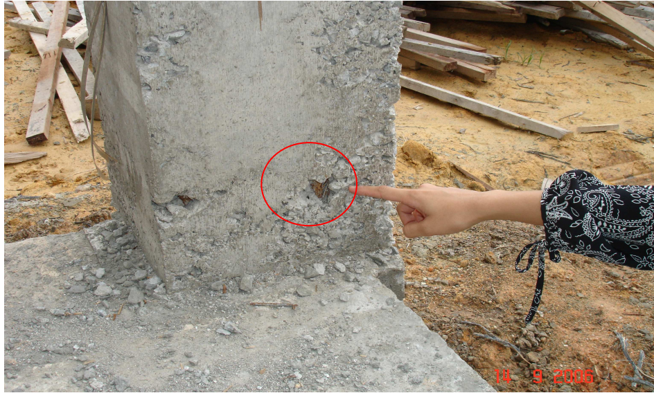
Foto 22 Campuran Konkrit Yang Tidak Sempurna Dan Berongga Serta Mendedahkan Besi Tetulang Pada Tiang
