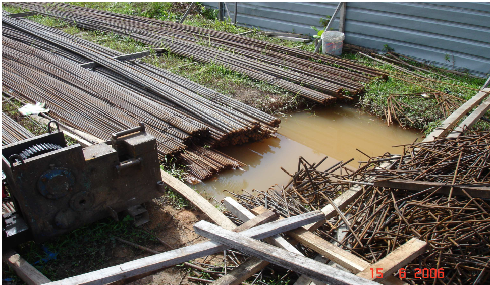
Foto 18 Simpanan Besi Yang Terendam Di Dalam Takungan Air Di Tapak Projek Masjid Transkrian
