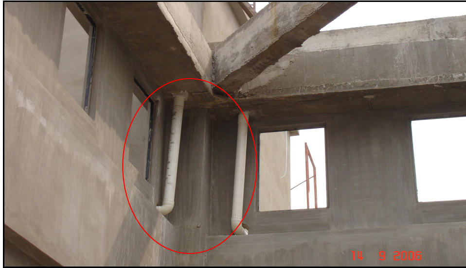
Foto 25 Salur Air Hujan Yang Dibina Semula Pada Tiang Dalam Ruang Solat Utama
