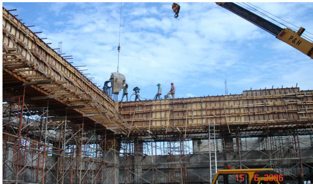
Foto 20 Pekerja Sedang Menjalankan Kerja Di Bahagian Bumbung Masjid Tanpa Memakai Topi Keselamatan
