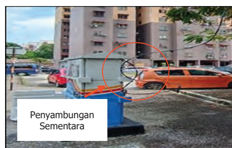
PPR Lembah Subang 2 - Keadaan Feeder Pillar yang dibuat Penyambungan Sementara dengan Tiang Lampu Sedia Ada Berdekatan (24.11.2022) (Sumber: Jabatan Audit Negara)
