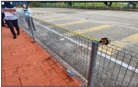
Laluan Pejalan Kaki di Seksyen U3, Shah Alam - Panjang Rel Penghadang Tidak Mematuhi Reka Bentuk Bandar Selamat (10.11.2022) (Sumber: Jabatan Audit Negara)
