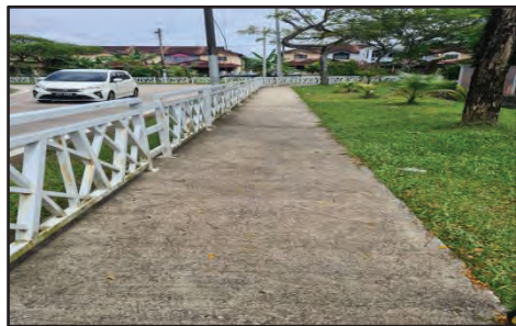
Laluan Pejalan Kaki di Jalan Tembikai Utama - Laluan Pejalan Kaki Tidak Dilengkapi Guiding Blocks/Tactile Blocks Untuk Kemudahan OKU (02.03.2023) (Sumber: Jabatan Audit Negara)
