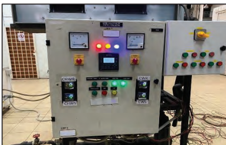
ABM Wilayah Tengah FCU Unit & Microprocessor Control Panel Tidak Digunakan Sejak Penerimaan Tahun 2018 (21.09.2023) (Sumber: Jabatan Audit Negara)
