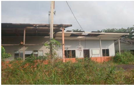
Kuari Pondok Limau, Dungun - Bangunan pusat timbang yang telah rosak dan ditumbuhi semak samun (08.02.2023) (Sumber: Jabatan Audit Negara)
