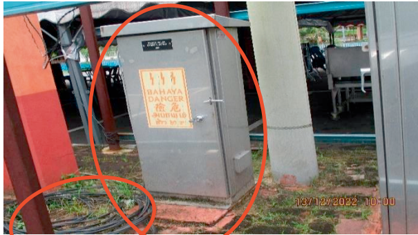
Tapak Penjaja Sungai Seguni - DB Rosak dan Kabel Elektrik Jatuh (13.12.2022) (Sumber: Jabatan Audit Negara)
