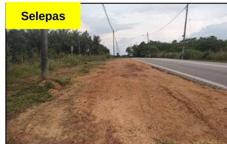
Jalan Durian Chondong (J34), Tangkak - Bahu Jalan Telah Ditambak dan Diratakan (04.10.2018) Sumber: JKR
