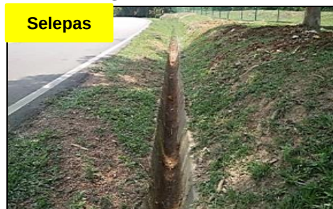
Jalan Lama UiTM (J263), Segamat - Longkang Konkrit Telah Dicuci (30.09.2018) Sumber: JKR
