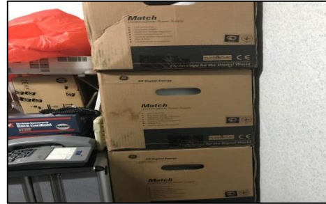
Bilik Server, Majlis Perbandaran Muar - Tiga unit UPS (Komputer) Tidak Digunakan (26.09.2017)
