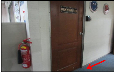
Bilik Server, Majlis Daerah Simpang Renggam - Lantai Bilik Server Tidak Ditinggikan (21.02.2018)
