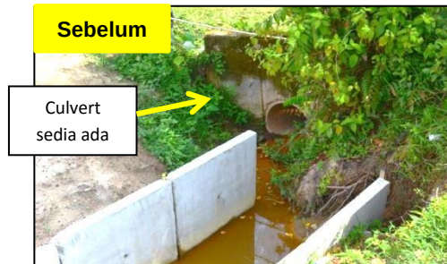
Jalan Semanyir (J73), Mersing - Pembinaan Longkang Tidak Sekata ( Uneven ) dan Jajarannya Terkeluar Daripada Pembetung ( Culvert ) Sedia Ada (24.04.2018)
