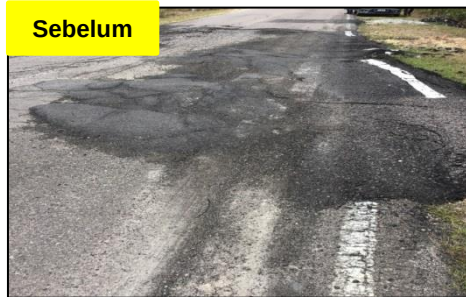
Jalan Tanjung Resang ( J183), Mersing - Gelinciran ( Slippage ) pada Pavement (24.04.2018)
