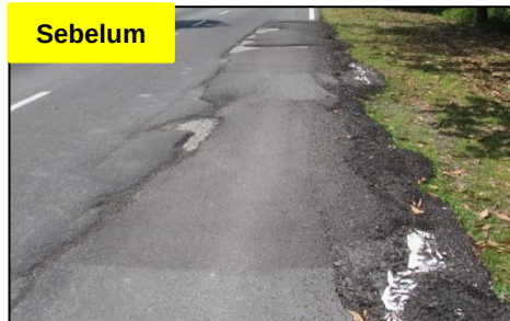
Jalan Desaru – Tanjung Balau (J226), Kota Tinggi - Gelinciran ( Slippage ) pada Pavement (21.02.2018)
