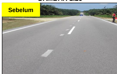
Jalan Perani (J179), Kota Tinggi - Garisan Jalan Sementara Tidak Ditanggalkan Dengan Sempurna Selepas Kerja Disiapkan (20.02.2018)
