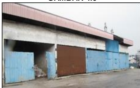
Jalan Perak 1, Pasir Gudang - Lot Kedai Bengkel Dengan Tempoh Tunggakan Cukai Taksiran Selama 23 Tahun (16.04.2018)
