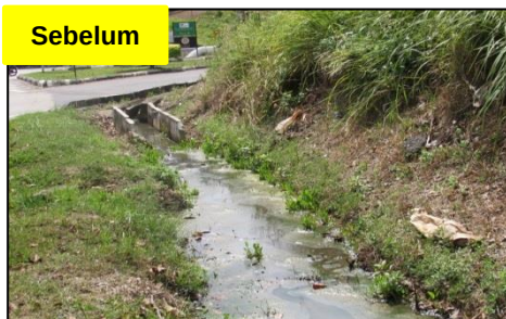
Jalan Lama Hospital, Segamat - Air Bertakung Dalam Longkang Tanah (28.02.2018)
