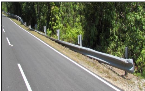
Jalan Balau - Sedili Kecil (J173), Kota Tinggi - Guardrail Packer Telah Dicuri (20.02.2018)
