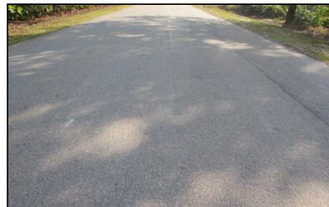
Jalan Perani (J179), Kota Tinggi - Garisan Jalan Pudar (20.02.2018)
