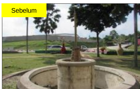
Air Pancut Tidak Berfungsi Laman Jalan Haji Hashim, Kluang (07.03.2017)
