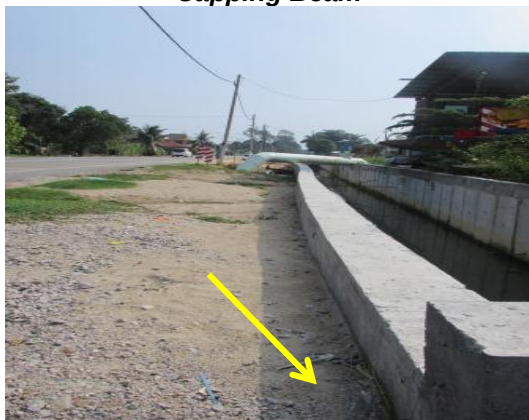
Gambar 2.1 Tambakan Tanah Lebih Rendah Dari Capping Beam
