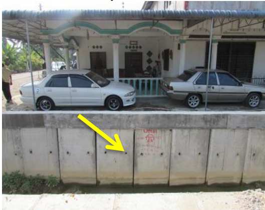
Gambar 2.5 Pemasangan Precast Drain Tidak Diperkemas
