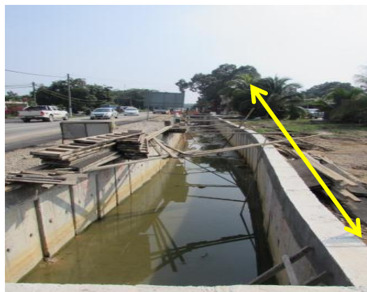
Gambar 2.22 Pagar Keselamatan Tidak Dipasang Di Kawasan Penempatan Penduduk
