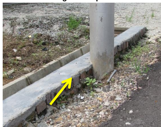
Gambar 2.11 Capping Beam Yang Tidak Diplaster Dengan Sempurna
