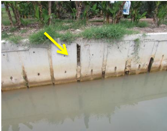
Gambar 2.9 Pemasangan Precast Drain Tidak Diperkemas
