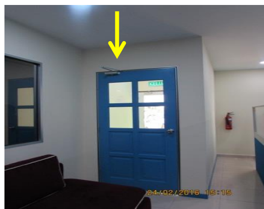
Gambar 5.5 Pintu Yang Dibekalkan Tidak Mengikut Spesifikasi
