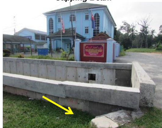
Gambar 2.2 Tambakan Tanah Lebih Rendah Dari Capping Beam
