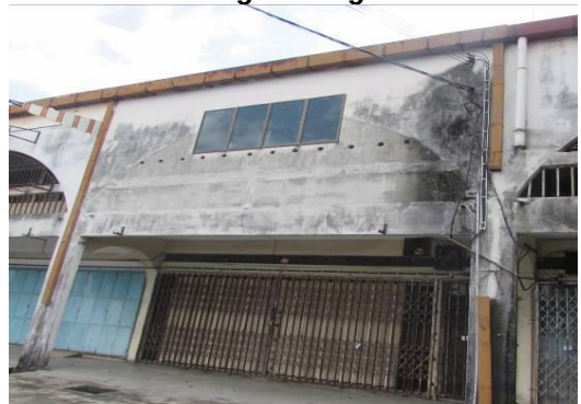
Gambar 4.25 Bangunan Rumah Kedai Dijadikan Sarang Burung Walit
