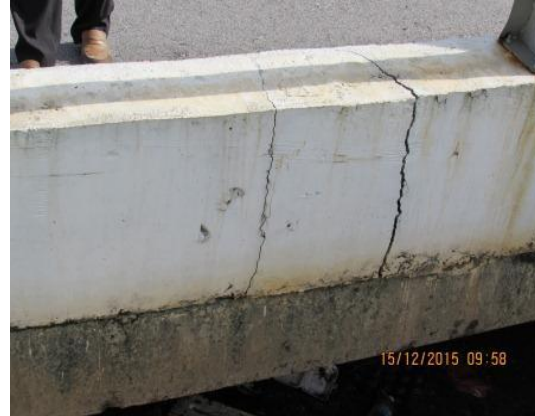
Gambar 2.14 Tembok Penghadang Retak
