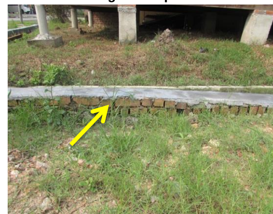
Gambar 2.12 Capping Beam Yang Tidak Diplaster Dengan Sempurna
