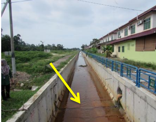
Gambar 2.7 Pemasangan Precast Drain Tidak Sempurna
