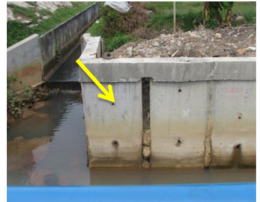
Gambar 2.10 Pemasangan Precast Drain Tidak Diperkemas
