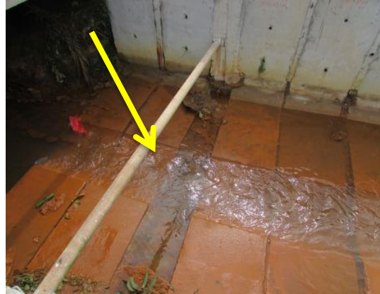
Gambar 2.8 Pemasangan Precast Drain Tidak Sempurna
