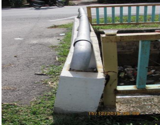
Gambar 2.13 Tembok Penghadang Senget
