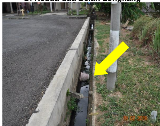
Gambar 1.35 Dinding Bata Tidak Dibina Di Kedua-dua Belah Longkang
