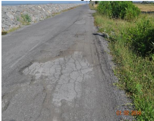
Gambar 1.2 Kerosakan Permukaan Jalan Jenis Pengupasan
