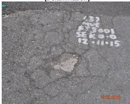
Gambar 1.28 Kerosakan Permukaan Jalan (Delamination)
