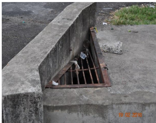
Gambar 1.25 Penutup Besi Telah Rosak
