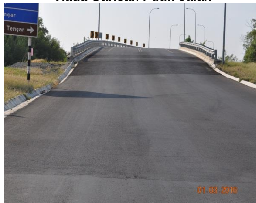
Gambar 1.12 Tiada Garisan Putih Jalan
