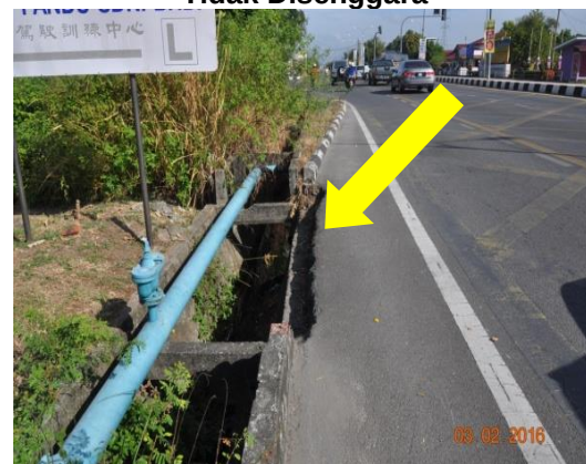
Gambar 1.18 Tebing Longkang Pecah Tidak Disenggara
