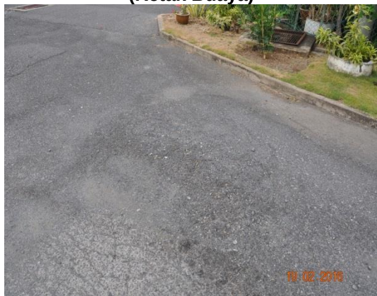
Gambar 1.29 Kerosakan Permukaan Jalan (Retak Buaya)
