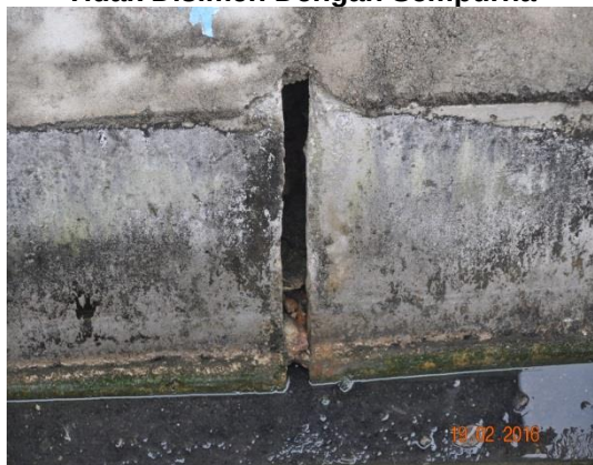
Gambar 1.27 Sambungan Longkang Tidak Disimen Dengan Sempurna
