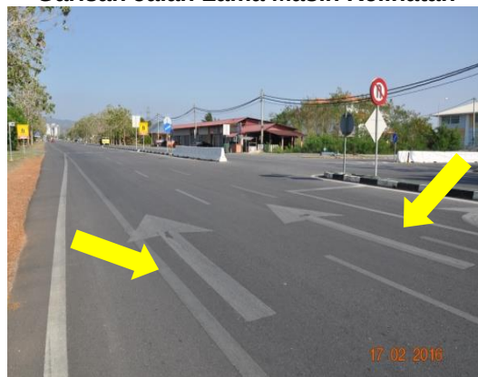
Gambar 1.20 Garisan Jalan Lama Masih Kelihatan
