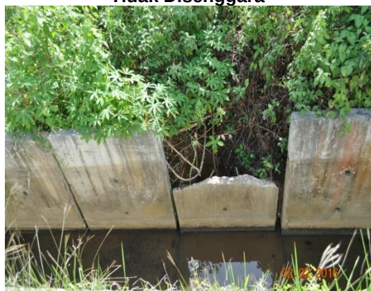
Gambar 1.17 Longkang Pecah Tidak Disenggara
