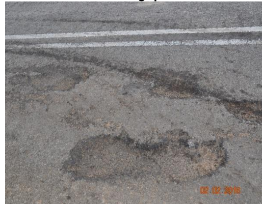
Gambar 1.3 Kerosakan Permukaan Jalan Jenis Pengupasan
