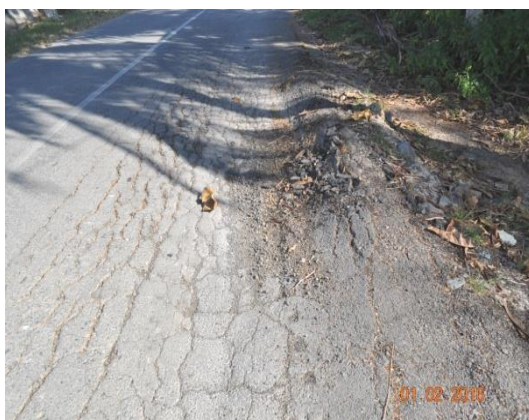
Gambar 1.1 Kerosakan Jalan Jenis Shoving
