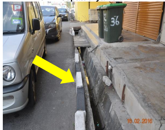
Gambar 1.37 Panjang Bebendul Jalan Terkurang Bina 6.4m sepatutnya 10.0m
