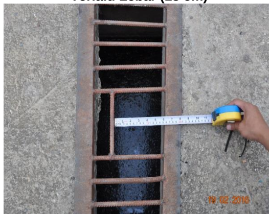
Gambar 1.26 Bukaan Jeriji Penutup Longkang Terlalu Lebar (15 cm)
