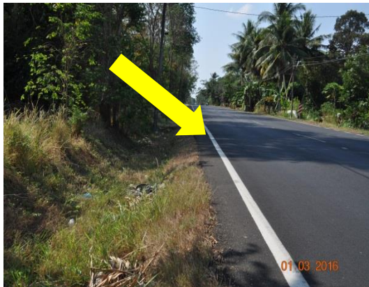
Gambar 1.23 Tiada Bahu Jalan
