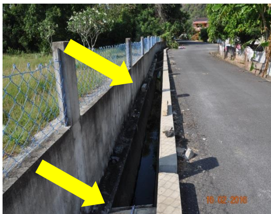
Gambar 1.31 Tupang Konkrit Yang Patah Tidak Dibaiki
