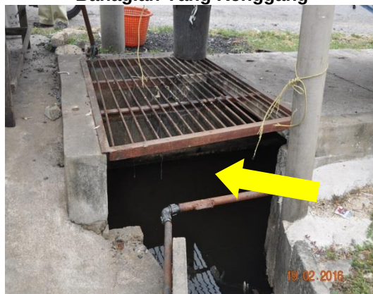
Gambar 1.33 Penutup Besi Tidak Disediakan Pada Bahagian Yang Renggang
