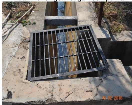
Gambar 1.30 Penutup Sump Tidak Berfungsi Dengan Sempurna
