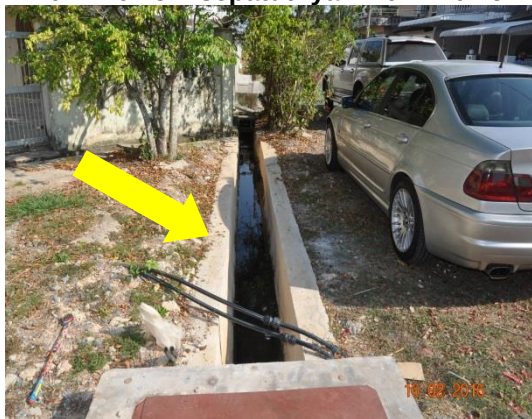
Gambar 1.36 Panjang Dinding Bata Terkurang Bina 11.0m x 0.45m sepatutnya 14.0m x 0.45m
