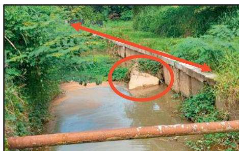
Projek PLSB Sungai Moyog (Pakej 1) - L-Shape yang Dipasang Telah Rebah (18.07.2022) (Sumber: Jabatan Audit Negara)
