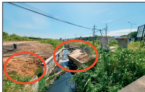
Projek Rancangan Tebatan Banjir Bandar Sierra, Lembangan Sg. Telipok, Kota Kinabalu - Isu Pengambilan Tanah dan Pemindahan Utiliti Telekom Belum Selesai (19.07.2022)
