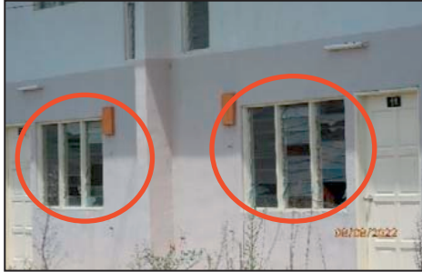
Fasa 1A, Kg. Sook, Keningau, Sabah - Cermin Tingkap Pecah (08.08.2022) (Sumber: Jabatan Audit Negara)
