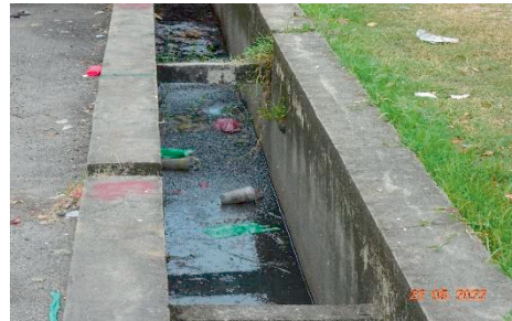
Bandar Bersepadu Pasir Puteh, Pasir Puteh - Longkang Tersumbat (22.06.2022) (Sumber: Jabatan Audit Negara)
