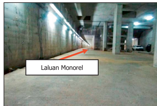
Terowong Monorel Telah Dibina Tetapi Belum Dilengkapkan Dengan Rel (16.08.2022) (Sumber: Jabatan Audit Negara)
