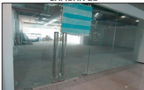
Galeria PjH, Presint 4 - Ruang Komersial yang Masih Belum Digunakan (07.06.2022) (Sumber: Jabatan Audit Negara)
