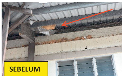
Kolej Kediaman V6, UTP, Perak - Ruang atap terkopak (14.06.2022) (Sumber: Jabatan Audit Negara)
