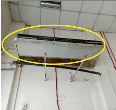
FR Tekam - Penyaman udara di dapur Coffee House rosak (07.06.2022) (Sumber: Jabatan Audit Negara)
