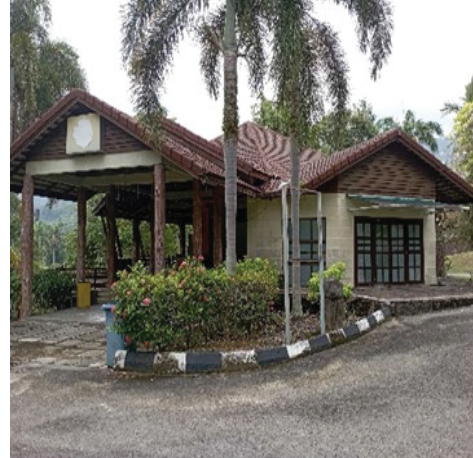
FR Hot Springs - Bangunan Cemara usang dan tidak dapat digunakan (25.05.2022) (Sumber: Jabatan Audit Negara)
