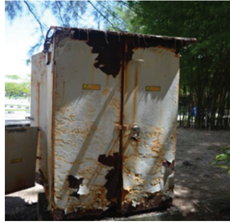
FR Tg. Leman - Electric board cabinet yang usang (25.07.2022) (Sumber: Jabatan Audit Negara)
