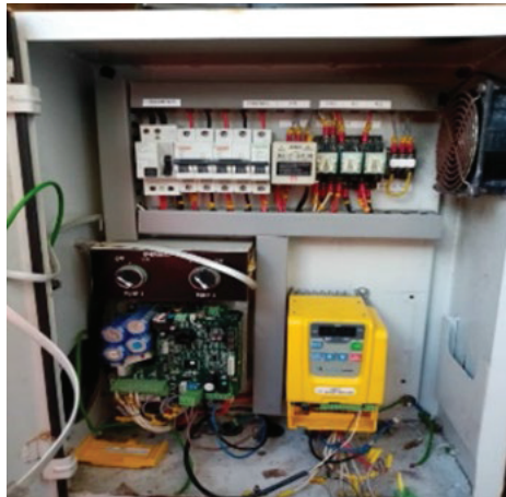
FR Tg. Leman - Inverter water pump rosak (25.07.2022) (Sumber: Unit Penyenggaraan, FR Tg. Leman)
