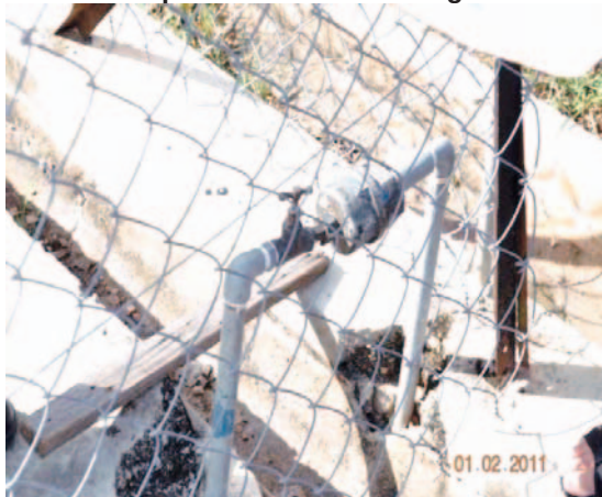
Gambar 3.7 Meter Terpakai Untuk Pemasangan Baru
