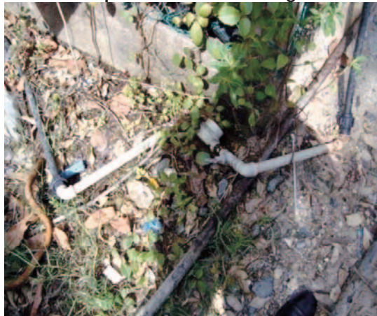
Gambar 3.8 Meter Terpakai Untuk Pemasangan Baru
