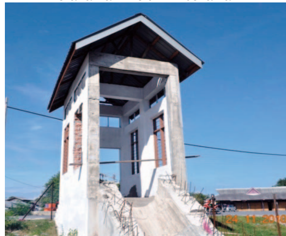
Gambar 4.9 Rumah Pam Tidak Berfungsi Kerana Pam Belum Dibekalkan
