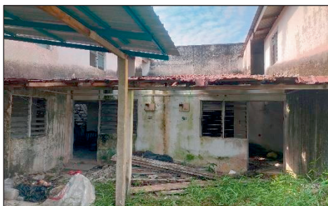
Projek Desa Seri Iskandar Fasa 1A - Antara Kerosakan di Unit Lot Kosong (23.03.2022) (Sumber: Jabatan Audit Negara)
