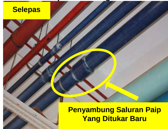
Gambar 3.12 Saluran Paip Bocor Yang Telah Dibaiki
