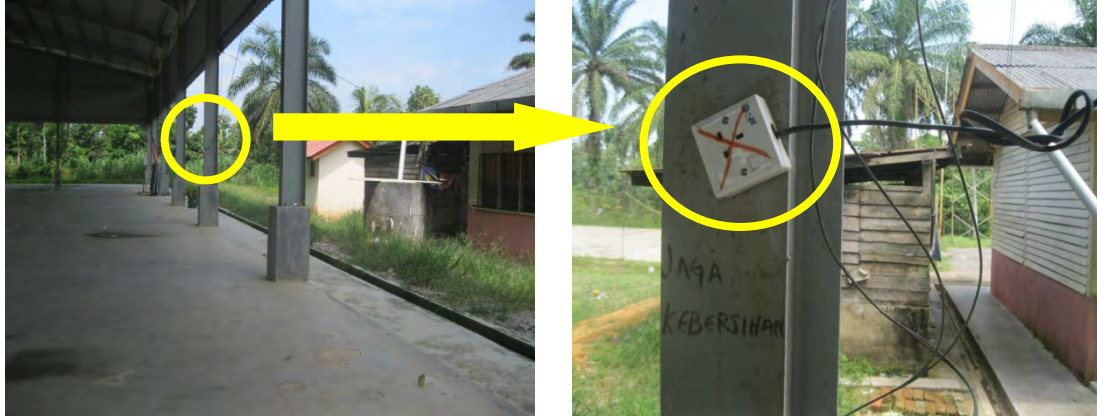
Gambar 2.10 Bekalan Elektrik Yang Telah Disambung Darpada Balai Raya Bersebelahan
