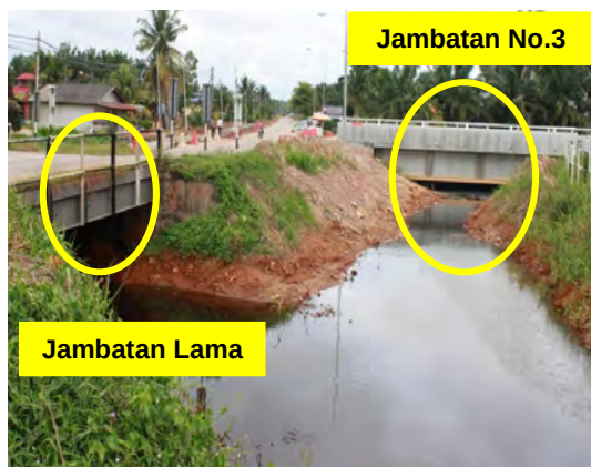
Gambar 5.32 Ketinggian Aras Bawah Jambatan Kurang Satu Meter Dari Aras Air Sungai
