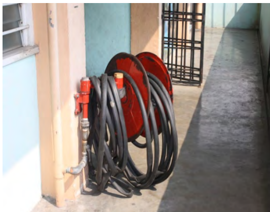
Gambar 6.27 Hos Bomba Tidak Boleh Digunakan
