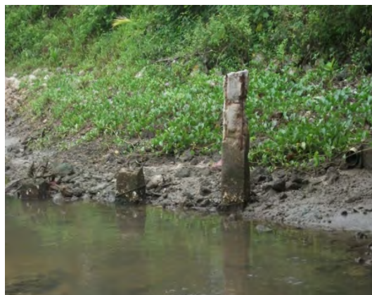
Gambar 5.26 Sisa Struktur Jambatan Lama Terbiar
