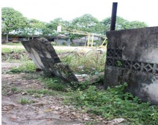
Gambar 9.29 Dinding Yang Hampir Roboh
