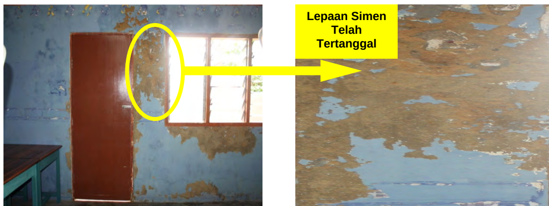
Gambar 6.8 Permukaan Dinding Bilik Darjah Yang Rosak
