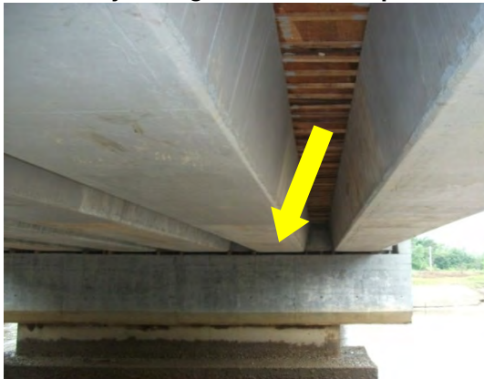
Gambar 5.29 Kerja Mengecat Tidak Sempurna
