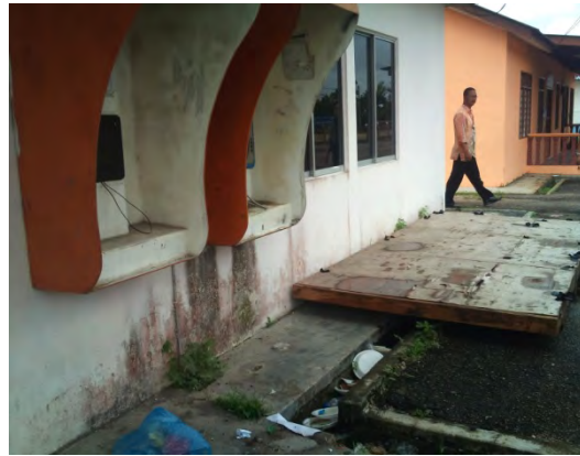
Gambar 11.12 Bangunan Luar Perpustakaan Tidak Diselenggara Dan Dibersihkan
