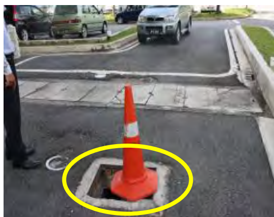
Gambar 3.10 Penutup Longkang Tidak Ditutup
