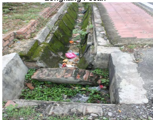
Gambar 9.30 Longkang Tersumbat Dan Dinding Longkang Pecah
