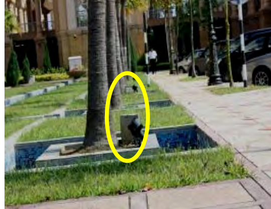
Gambar 3.2 Lampu Fasad Tidak Berfungsi
