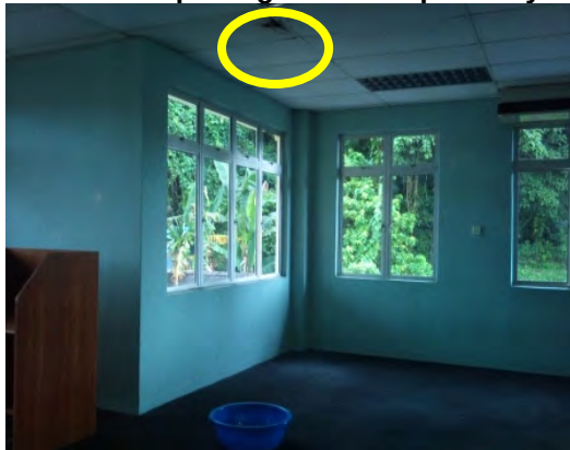
Gambar 11.13 Bumbung Bocor Menyebabkan Ruang Tidak Dapat Digunakan Sepenuhnya
