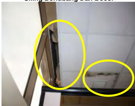
Gambar 3.8 Siling Berlubang Dan Bocor
