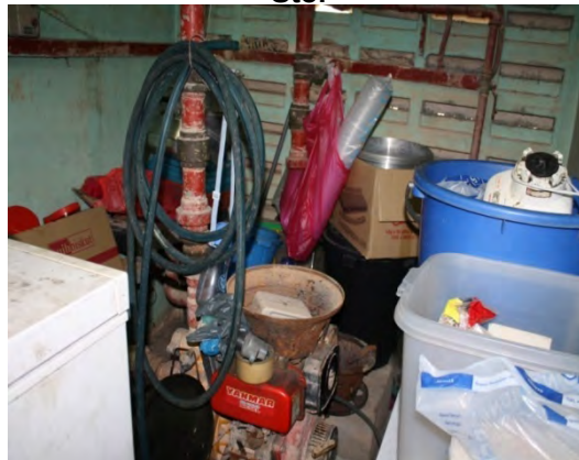
Gambar 6.28 Ruang Menyimpan Hos Bomba Dijadikan Stor
