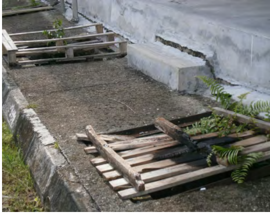
Gambar 8.7 Besi Penutup Parit Di Kaki Lima Telah Hilang
