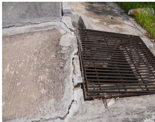
Gambar 8.6 Kaki Lima Bangunan Yang Retak
