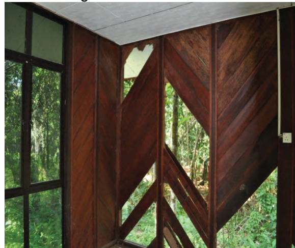
Foto 2.12 Dinding Gerai Cenderamata Rosak
