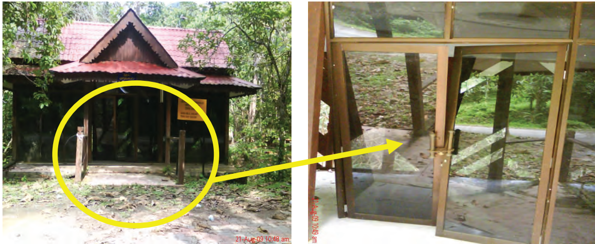
Foto 2.10 Pintu Gerai Cenderamata Rosak
