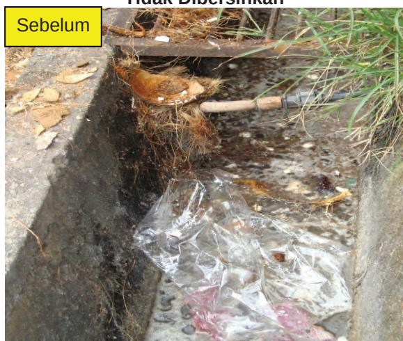
Foto 3.9 Longgang Kotor Dan Tersumbat Tidak Dibersihkan
