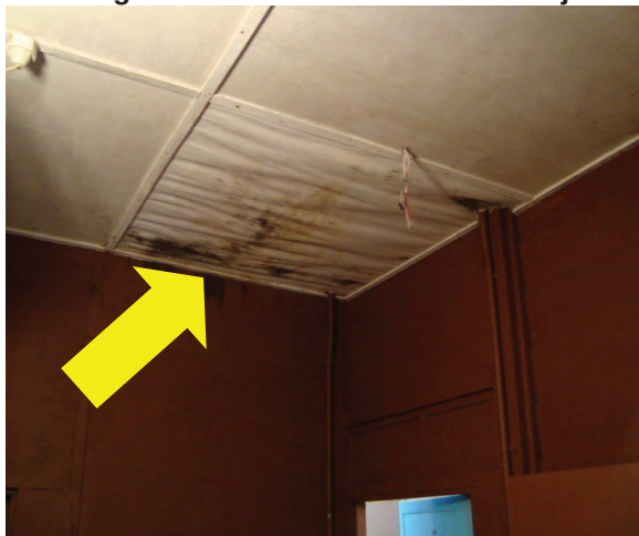
Foto 2.19 Siling Chalet Rosak Dimasuki Air Hujan
