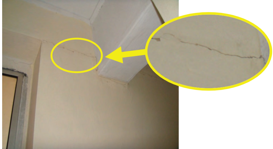
Foto 4.11 Keretakan Pada Pertemuan Dinding dan Rasuk
