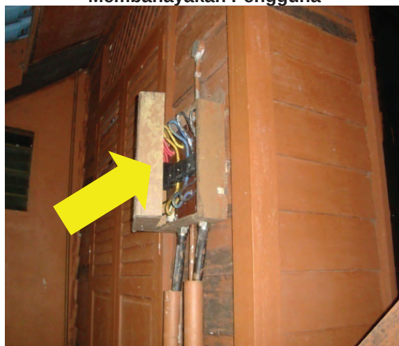
Foto 2.18 Pemasangan Elektrik Membahayakan Pengguna
