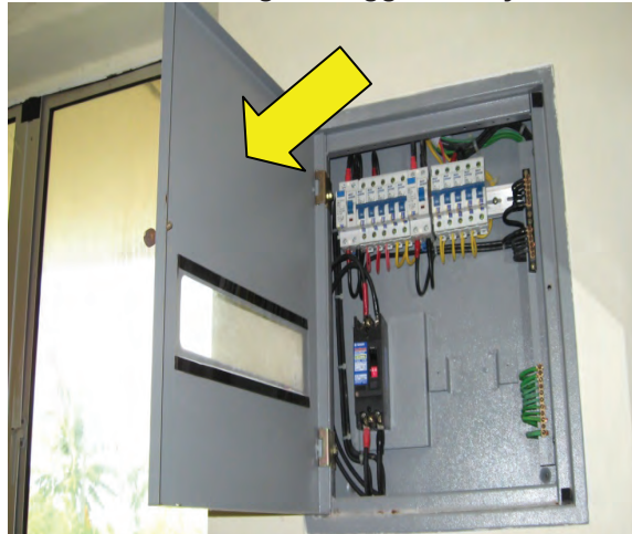
Foto 4.17 Papan Agihan Elektrik Tidak Dilabelkan Dan Dikongsi Penggunaannya
