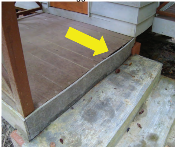
Foto 2.21 Lantai Tangga Chalet Rosak
