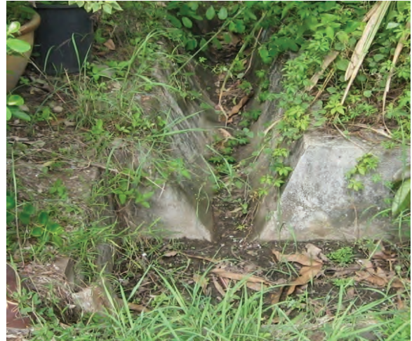
Foto 3.12 Longkang Kotor Dan Tersumbat (Tiada Tindakan Diambil)
