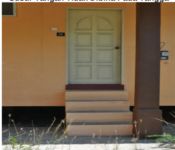
Foto 4.4 Susur Tangan Tidak Dibina Pada Tangga
