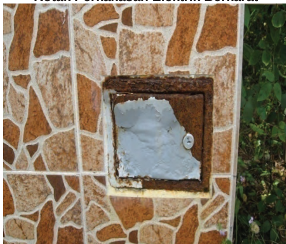
Foto 4.15 Kotak Perkakasan Elektrik Berkarat
