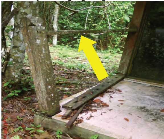
Foto 2.11 Kayu Pemegang Tangan Rosak
