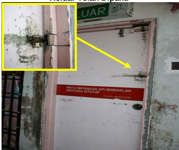
Gambar 4.11 Pintu Rintangan Api Menuju Ke Tangga Keluar Telah Dipaku
