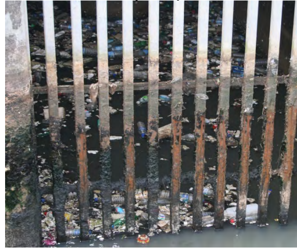
Gambar 6.22 Sampah Sarap Yang Tidak Dibersihkan Di Pump Sump 1
