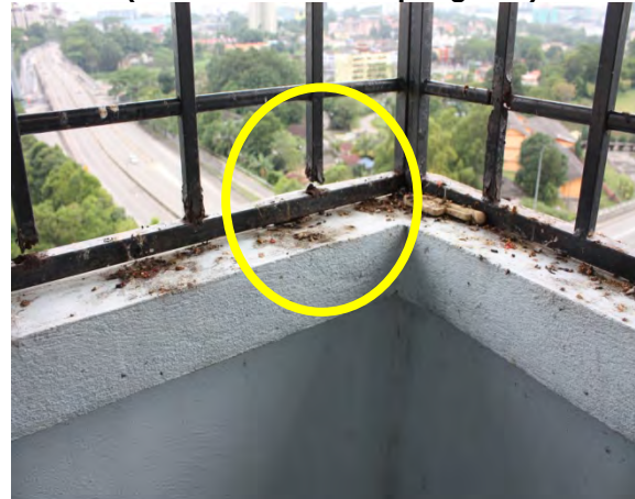
Gambar 4.8 Jeriji Besi Yang Berkarat (Kuarters Tidak Berpenghuni)
