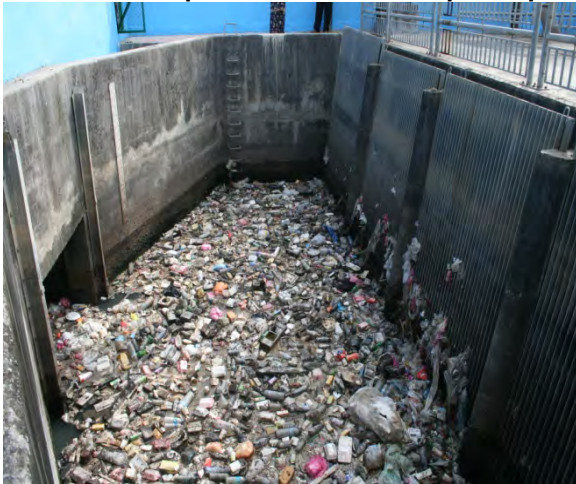
Gambar 6.11 Sampah Sarap Yang Terhalang Oleh Trash Screen Daripada Memasuki Pump Sump
