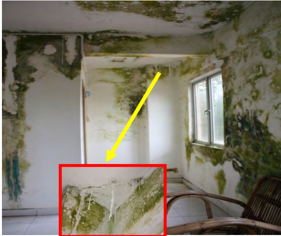
Gambar 4.1 Resapan Air Di Dinding Dan Siling Menyebabkannya Dipenuhi Lumut (Kuarters Tidak Berpenghuni)
