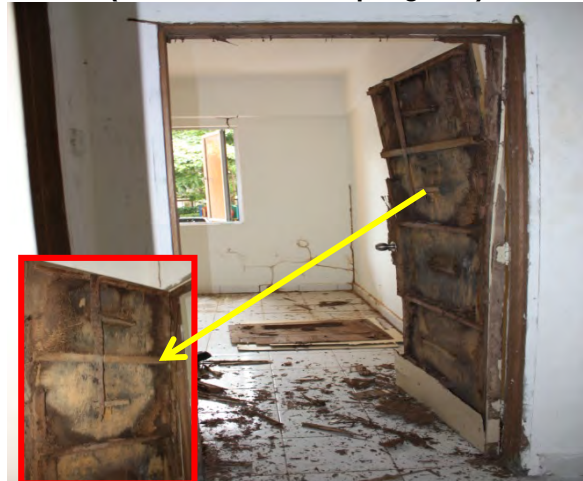
Gambar 4.4 Pintu Rosak Disebabkan Anai-Anai (Kuarters Tidak Berpenghuni)
