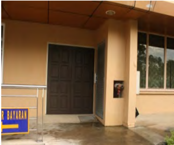
Gambar 11.6 Bocor Di Antara Bangunan Lama Dengan Baru
