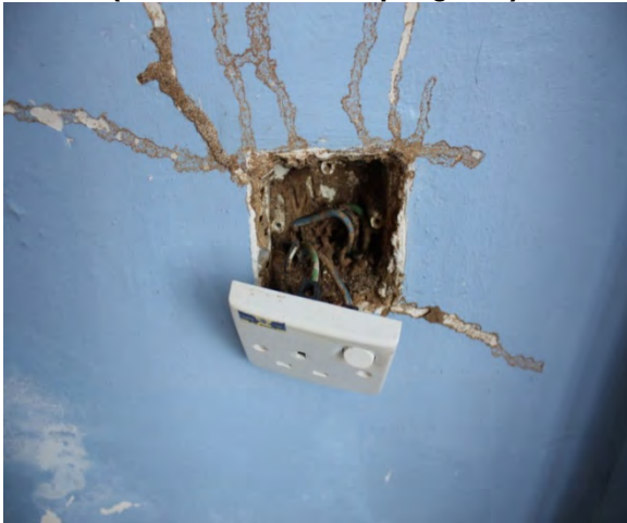
Gambar 4.3 Soket Elektrik Rosak Disebabkan Anai-Anai (Kuarters Tidak Berpenghuni)
