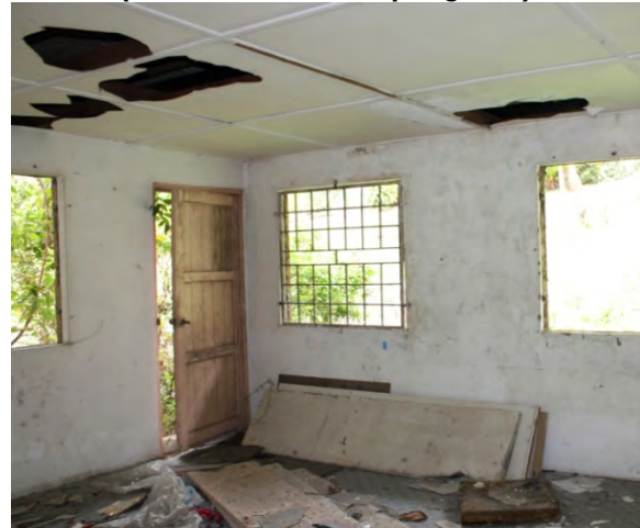
Gambar 4.10 Keadaan Di Dalam Kuarters Yang Rosak Teruk (Kuarters Tidak Berpenghuni)
