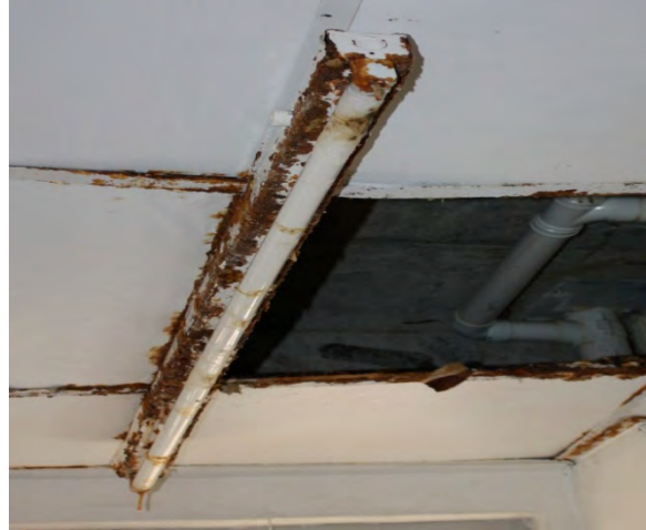
Gambar 4.2 Resapan Air Di Siling Menyebabkan Lampu Kalimantang Berkarat (Kuarters Tidak Berpenghuni)
