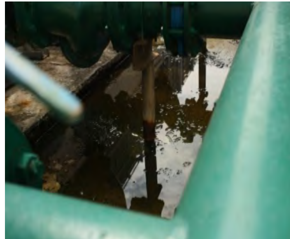
Gambar 11.9 Air Bertakung Di Bawah Tangki Dan Lantai
