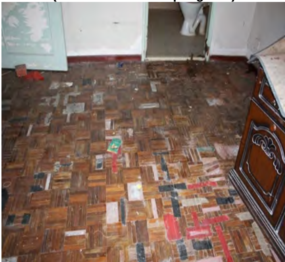
Gambar 4.5 Lantai Parket Yang Telah Rosak (Kuarters Tidak Berpenghuni)
