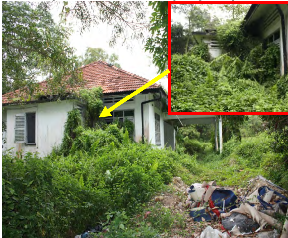
Gambar 4.9 Kuarters Rosak Dan Usang (Kuarters Tidak Berpenghuni)
