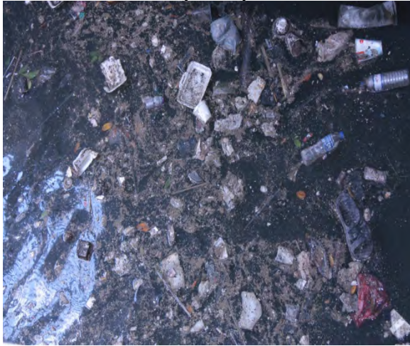
Gambar 6.21 Sampah Sarap Yang Tidak Dibersihkan Di Pump Sump 2
