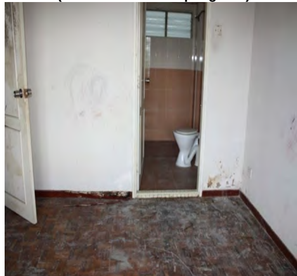
Gambar 4.6 Lantai Parket Yang Telah Rosak (Kuarters Tidak Berpenghuni)
