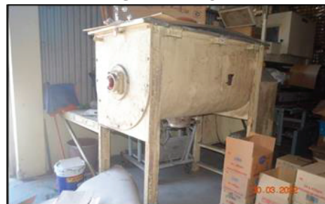
Kilang PERTIMA Chendering, Terengganu - Sacher Machine Rosak dan Terbiar (30.03.2022) (Sumber: Jabatan Audit Negara)
