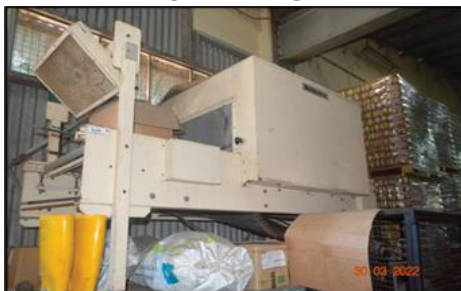
Kilang PERTIMA Chendering, Terengganu - Schinder Full Auto PE Shrin Rosak dan Terbiar (30.03.2022) (Sumber: Jabatan Audit Negara)
