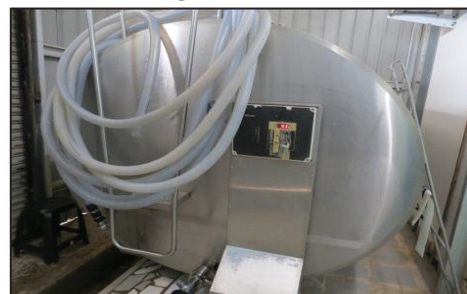
Kampung Binakaan, Sook, Keningau - Chiller Tank Milik JPV Sabah Dengan Muatan Susu 6,000 kg (23.03.2022) (Sumber: Jabatan Audit Negara)
