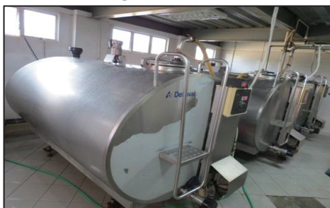
Kampung Binakaan, Sook, Keningau - Chiller Tank Milik SLDBSB Dengan Muatan Susu 3,200 kg (23.03.2022) (Sumber: Jabatan Audit Negara)
