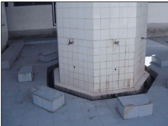
Foto 2.11 Tempat Mengambil Wuduk Yang Kotor Dan Tidak Dibersihkan
