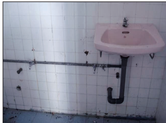
Foto 2.12 Tempat Mengambil Wuduk Yang Kotor Dan Tidak Dibersihkan
