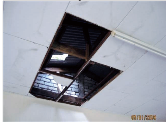
Foto 2.8 Bumbung Pecah Dan Siling Tertanggal Belum Diganti Semula
