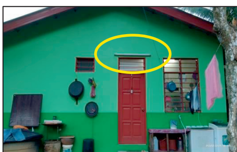
Manek Urai, Kuala Krai - Awning Belakang Tidak Dipasang (11.01.2022) (Sumber: Jabatan Audit Negara)
