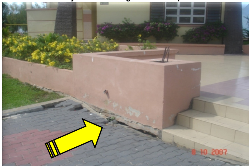
Foto 43 Lantai Pejalan Kaki Mengalami Mendapan Tanah
