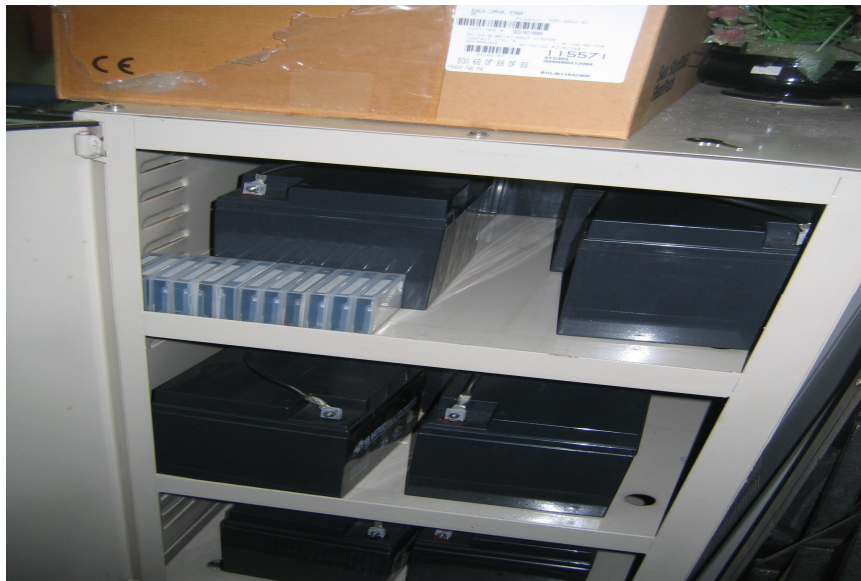
Foto 25 Peti Keselamatan Di Bilik Server Pejabat PTG
