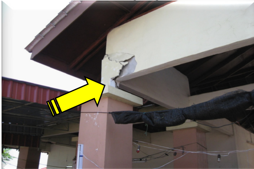
Foto 49 Retakan Berlaku Pada Tiang Bangunan Gerai Makan
