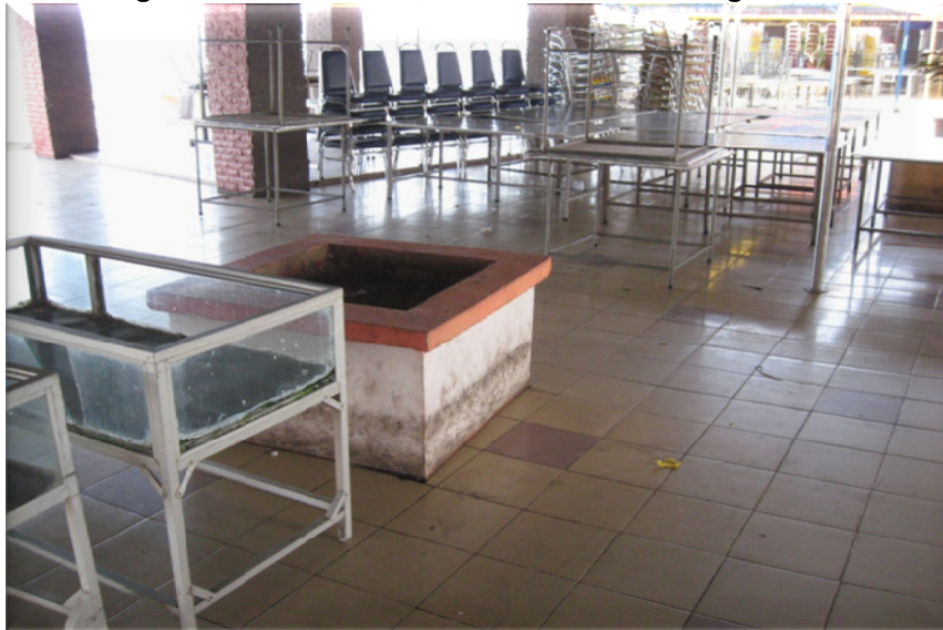
Foto 41 Lantai Jubin Di Gerai Makan Yang Berkeadaan Kotor Dan Tidak Dicuci Dengan Bersih
