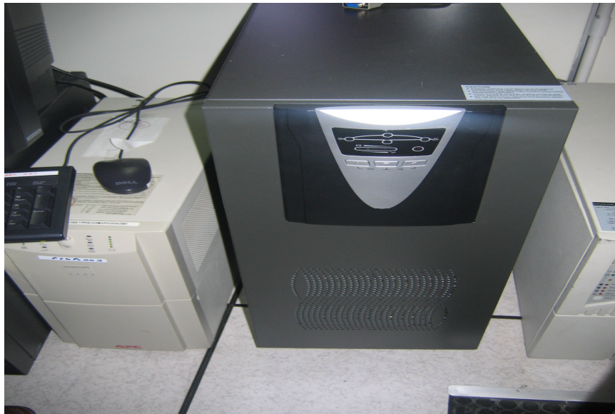
Foto 32 Uninterrupted Power Supply (UPS) Di Bilik Server
