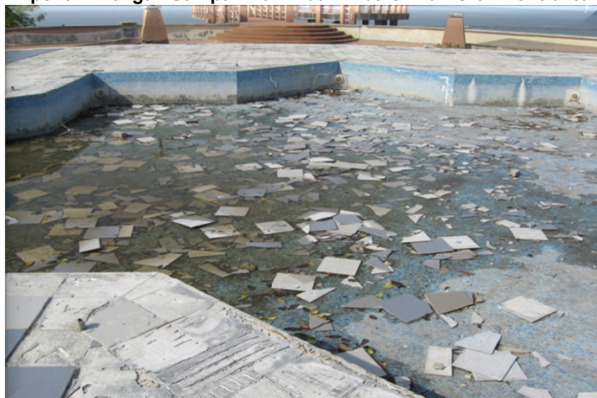
Foto 38 Kolam Air Di Water Fountain Structures Dipenuhi Dengan Sampah Dan Tidak Dibersihkan Oleh Kontraktor
