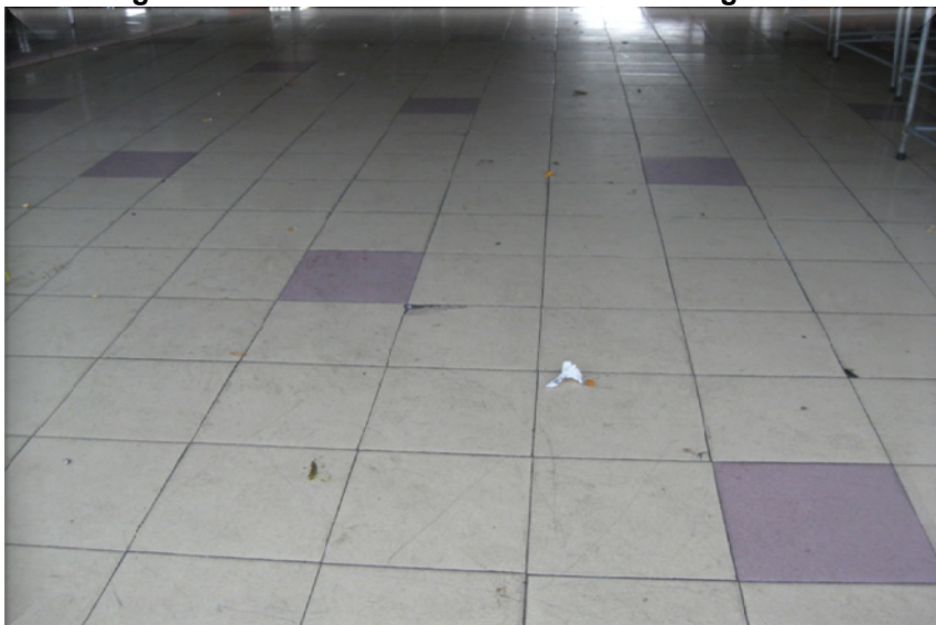
Foto 40 Lantai Jubin Di Gerai Makan Yang Berkeadaan Kotor Dan Tidak Dicuci Dengan Bersih
