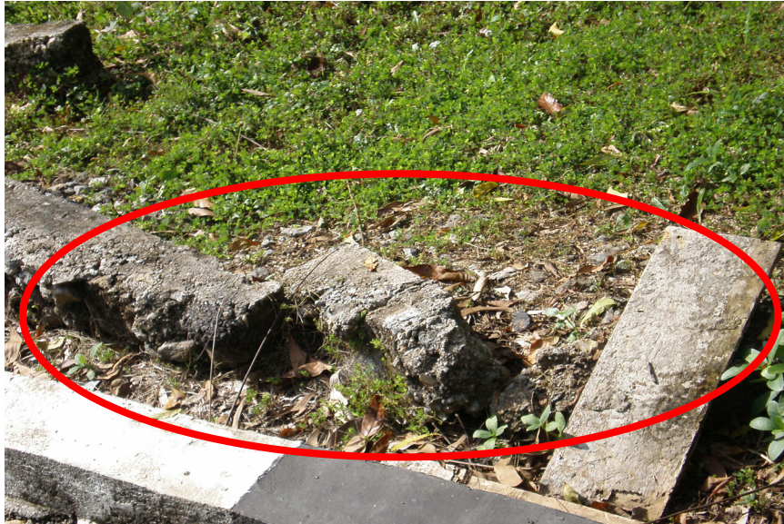
Foto 15 Bahan Buangan Tidak Dibersihkan
