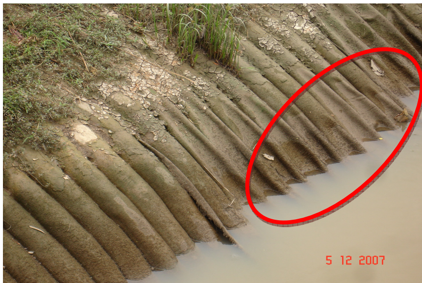
Foto 9 Sand Filled Mattress Yang Telah Bocor
