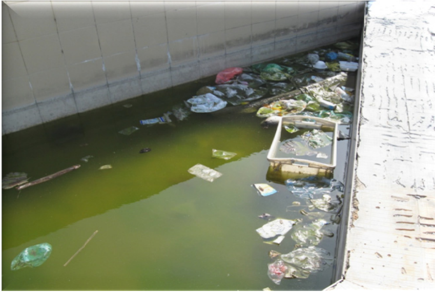
Foto 39 Kolam Air Di Water Fountain Structures Dipenuhi Dengan Sampah Dan Tidak Dibersihkan Oleh Kontraktor
