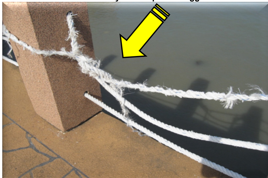
Foto 48 Guard Rail di Man-Made Island Yang Diperbuat Daripada Tali Telah Terputus Dan Membahayakan Kepada Pengguna
