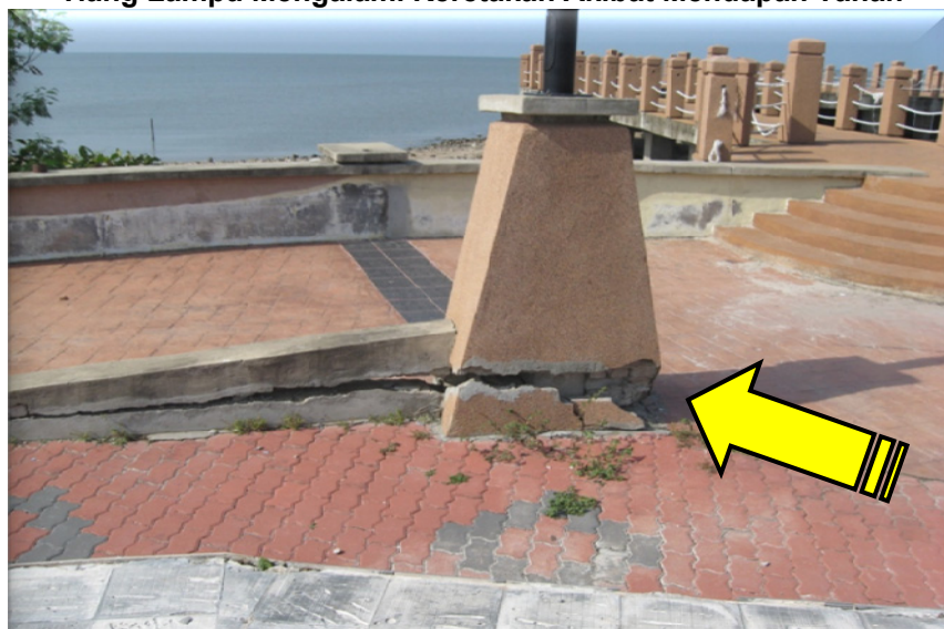
Foto 46 Tiang Lampu Mengalami Keretakan Akibat Mendapan Tanah
