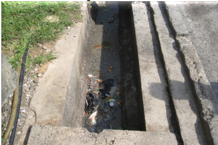
Foto 42 Longkang Yang Dipenuhi Dengan Bahan Buangan Makanan Dari Gerai Makan Yang Tidak Dibersihkan Oleh Kontraktor
