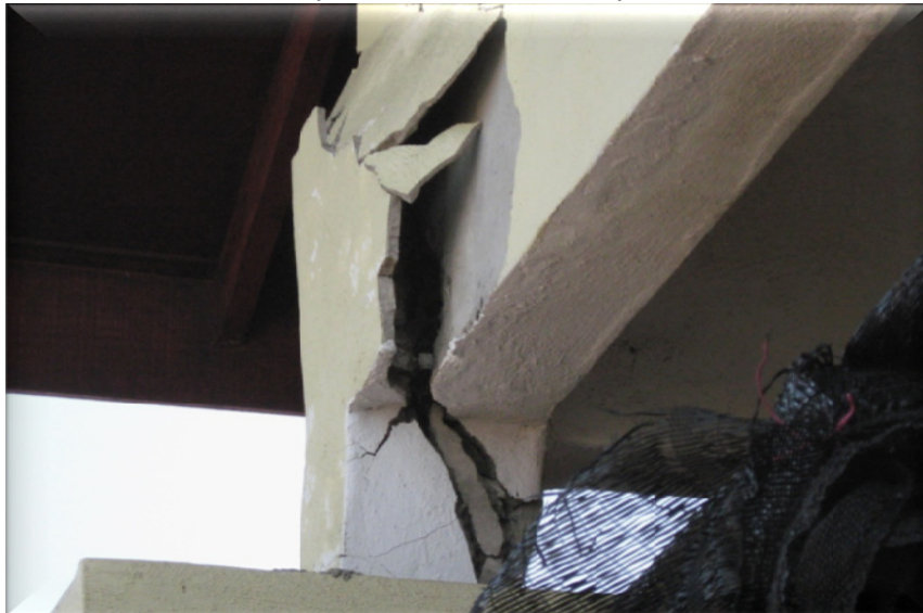
Foto 50 Retakan Pada Tiang Bangunan Gerai Makan Sehingga Menampakkan Besi Didalamnya ( Gambar Jarak Dekat )
