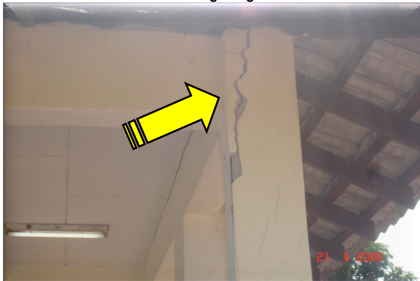
Foto 51 Retakan Pada Tiang Bangunan Tandas
