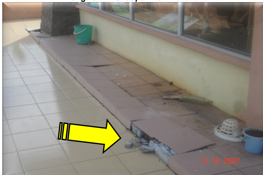
Foto 44 Lantai Bahagian Tepi Bangunan Kedai Cenderahati Mengalami Mendapan Dan Rekahan
