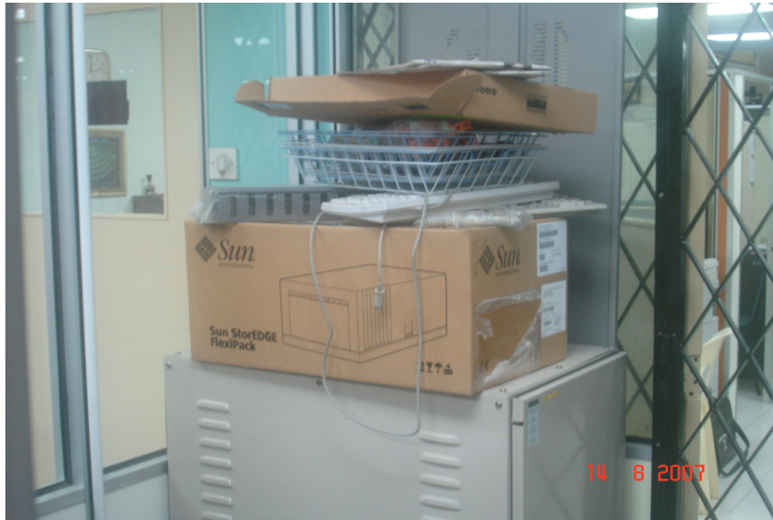
Foto 29 Kotak Di dalam Bilik Server
