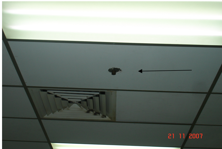
Foto 30 Alat Pancuran Air Di siling Bilik Server
