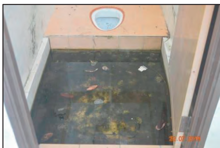
RPMM Pulau Duyong II, Kuala Terengganu - Air Bertakung Dalam Tandas Pondok Pengawal (22.07.2019) (Sumber: Jabatan Audit Negara)
