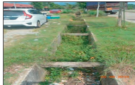
RMM Padang Kubu, Kemaman - Longkang Tidak Dibersihkan (05.08.2019) (Sumber: Jabatan Audit Negara)
