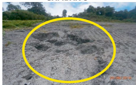
Chainage 25+800 - Keadaan Cerun yang Runtuh (29.08.2019) (Sumber: Jabatan Audit Negara)
