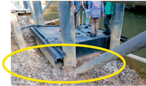
SAWAS Pakej 1 (Rumah Unchau) - Tiada Embankment Protection di Muka Sauk (22.08.2019) (Sumber: Jabatan Audit Negara)
