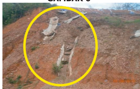
Chainage 21+500 - Keadaan Cerun dan Longkang Tangga yang Runtuh (29.08.2019) (Sumber: Jabatan Audit Negara)
