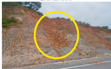
Chainage 22+200 - Keadaan Cerun yang Runtuh (29.08.2019) (Sumber: Jabatan Audit Negara)
