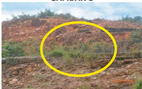
Chainage 20+900 - Kedudukan Cerun dan Bahu Saluran yang Runtuh (29.08.2019) (Sumber: Jabatan Audit Negara)
