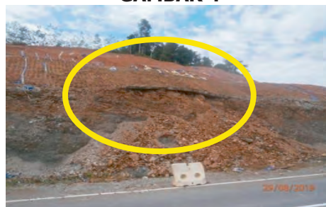
Chainage 21+500 - Kedudukan Cerun dan Bahu Saluran yang Runtuh (29.08.2019) (Sumber: Jabatan Audit Negara)
