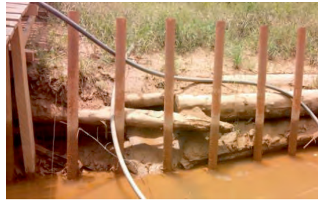
SAWAS Pakej 1 (Rumah Banta) - Embankment Protection Tidak Berkesan (22.08.2019) (Sumber: Jabatan Audit Negara)
