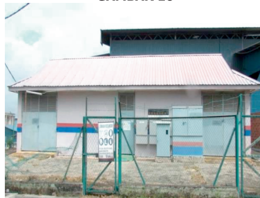
HS(D)30710 PTD8082 Taman Perindustrian Bakri, Muar - Lot tapak pembekal utiliti masih belum dipindah milik (10.11.2021) (Sumber: Jabatan Audit Negara)
