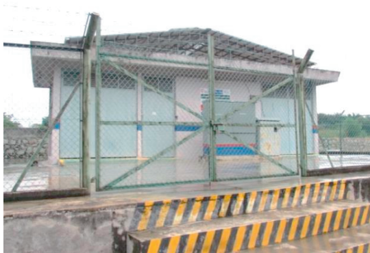
PN.9636 LOT 8725 Taman Perindustrian Bakri, Muar - Lot tapak pembekal utiliti masih belum dipindah milik (10.11.2021) (Sumber: Jabatan Audit Negara)
