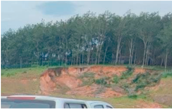
LRA Sungai Linggi Keruntuhan Cerun (21 Januari 2022) (Sumber: Jabatan Audit Negara)
