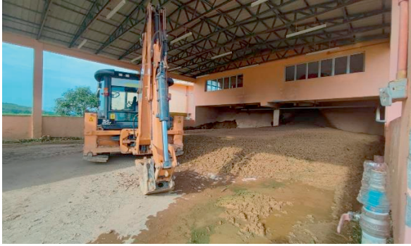
LRA Sungai Linggi Sludge Cake Selepas Rawatan Air (21 Januari 2022) (Sumber: Jabatan Audit Negara)
