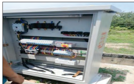
Kawasan Pembangunan TAMP Keadaan Feeder Pillar yang Siap Dibaik Pulih (18.07.2019) (Sumber: Jabatan Audit Negara)
