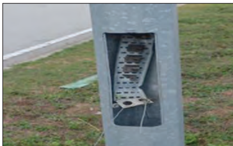
Kawasan Pembangunan TAMP - Komponen Pendawaian Tiang Lampu yang Dicuri (18.07.2019) (Sumber: Jabatan Audit Negara)
