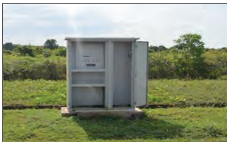
Kawasan Pembangunan TAMP - Komponen Feeder Pillar yang Dicuri (18.07.2019) (Sumber: Jabatan Audit Negara)
