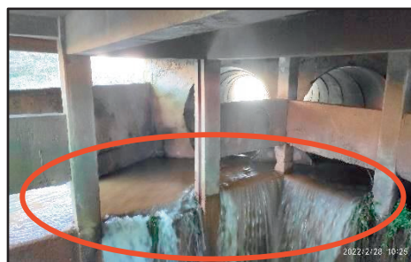
Kolam Takungan Universiti Malaya - Kawasan Zon Salur Keluar Tanpa Struktur Kawalan Kuantiti Air Keluar di Mana Tiada Multilevel Riser dan Spillway (28.02.2022) (Sumber: Jabatan Audit Negara)
