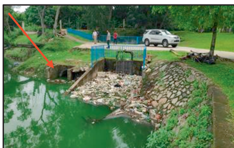
Kolam Metropolitan Kepong - Salur Keluar Tiada Multilevel Riser dan Spillway (12.11.2021) (Sumber: Jabatan Audit Negara)
