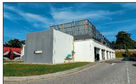
Blok Mekanikal - Struktur Binaan Baharu yang Tidak Dipasang Dengan Reka Bentuk Fasad (14.01.2022) (Sumber: Jabatan Audit Negara)
