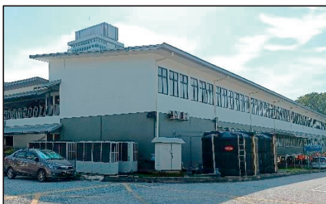
Blok Pejabat Sementara - Struktur Binaan Baharu yang Tidak Dipasang Dengan Reka Bentuk Fasad (14.01.2022) (Sumber: Jabatan Audit Negara)
