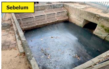
Pantai Teluk Kemang, Port Dickson - Struktur sump Dipenuhi Dengan Pasir, Kelodak dan Sampah (08.01.2020) (Sumber: Jabatan Audit Negara)
