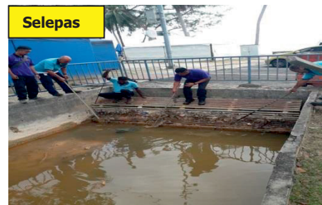
Pantai Teluk Kemang, Port Dickson - Kerja Penyelenggaraan sump oleh Pihak MPPD Selepas Mendapat Teguran Audit (25.06.2020) (Sumber: JPSNS)
