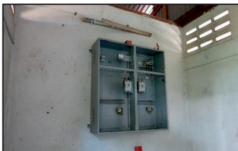
Padang Hoki, Kompleks Sukan Muadzam Shah - Sub Switch Board Hilang (04.03.2020) (Sumber: Jabatan Audit Negara)
