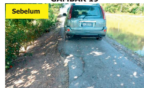
Kg. Alor Parit, Mukim Bukit Raya, Pendang - Jalan Rosak (30.03.2020) (Sumber: Jabatan Audit Negara)
