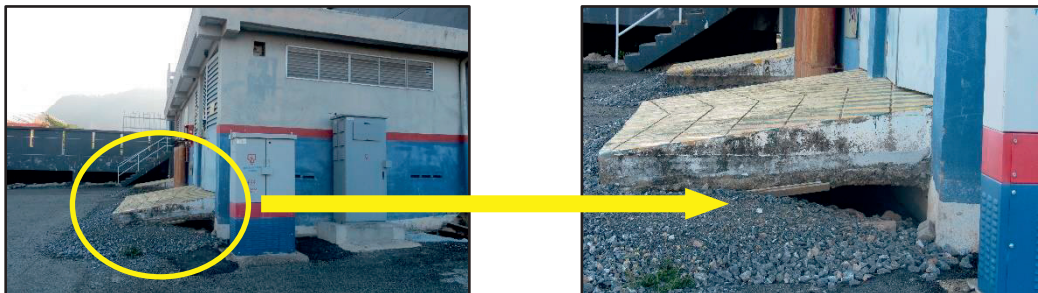
Kompleks Akuatik, Gunung Keriang - Mendapan Tanah Menyebabkan Lantai Merekah (03.03.2020) (Sumber: Jabatan Audit Negara)
