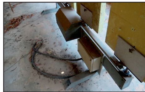
Lapang Sasar Menembak, Pokok Sena - Mechanical Marker Tidak Berfungsi bagi Lapangan Sasar Menembak 25 Meter (03.03.2020) (Sumber: Jabatan Audit Negara)
