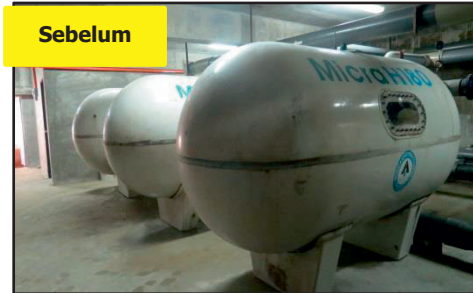
Kompleks Akuatik, Gunung Keriang - Kebocoran Penapis Air (03.03.2020) (Sumber: Jabatan Audit Negara)
