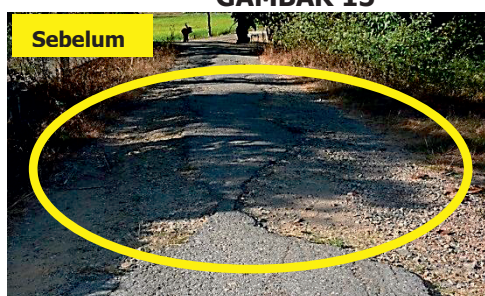
Kg. Batu 19, Kuala Nerang - Jalan Rosak (23.01.2020) (Sumber: Jabatan Audit Negara)
