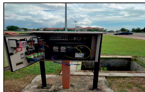
Padang Stadium Sultan Abdul Halim - Panel Sub Mersible Pump tidak berfungsi (05.11.2020) (Sumber: Jabatan Audit Negara)
