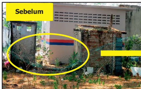
Padang Hoki, Kompleks Sukan Muadzam Shah - Pagar yang Telah Rosak (04.03.2020) (Sumber: Jabatan Audit Negara)
