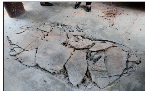
Pejabat Jabatan Landskap, Hutan Bandar, MBJB - Kerosakan Infra berdekatan Tapak Binaan (19.07.2021) (Sumber: Jabatan Audit Negara)
