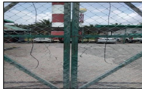
Pintu Pagar - Kerja Mengecat Tidak Dilaksanakan (03.03.2020) (Sumber: Jabatan Audit Negara)
