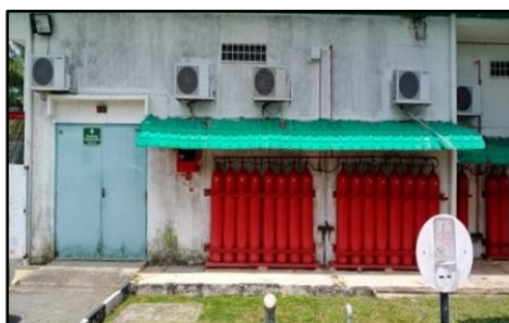
Bangunan Utama - Kerja Mengecat Tidak Dilaksanakan (03.03.2020) (Sumber: Jabatan Audit Negara)
