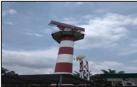
Tiang Antena - Kerja Mengecat Tidak Dilaksanakan (03.03.2020) (Sumber: Jabatan Audit Negara)
