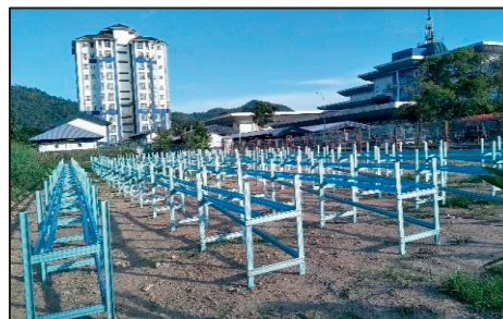
Projek Fertigasi Gantung Usahawan PPK Batu Pahat Tengah, Johor - Projek di Peringkat Pemasangan Peralatan (29.11.2021) (Sumber: Jabatan Audit Negara)
